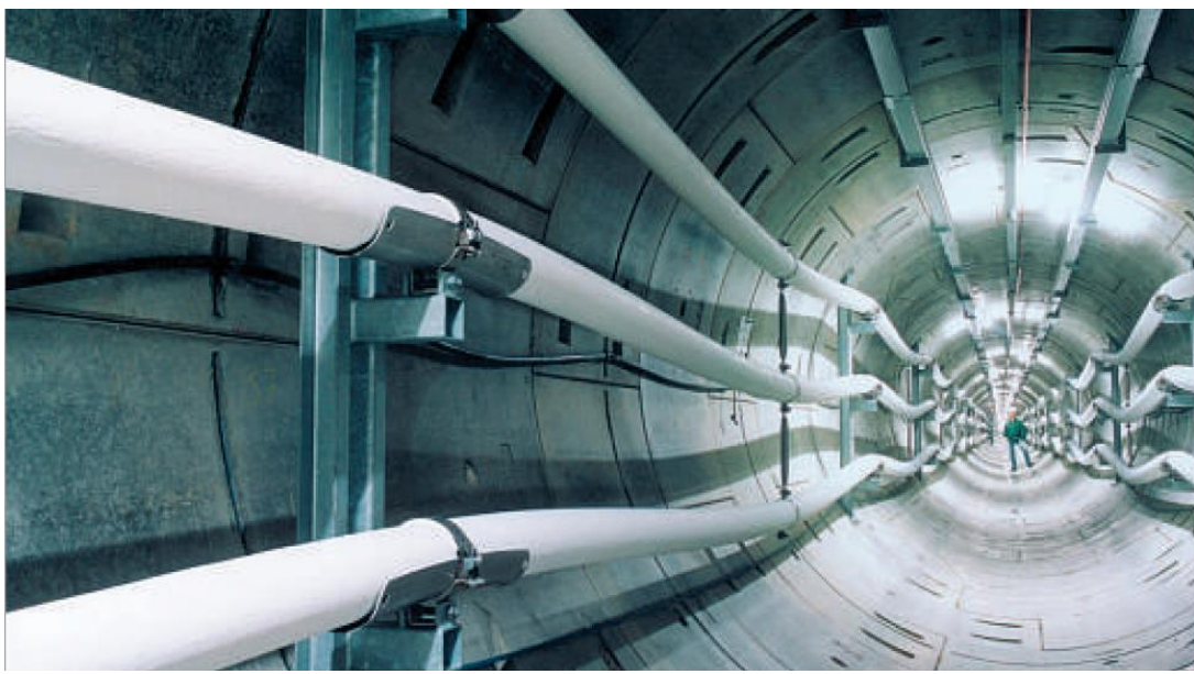
Slika U3. 400 kV kablovski sistem u tunelu dužine 6.3 km ispod centra Berlina
